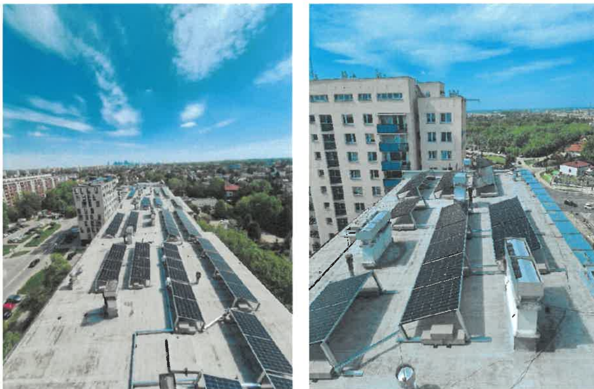
Fot. Panele fotowoltaiczne na budynku przy ul. Sterniczej 129 i 131
