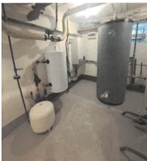
Fot. Pompa ciepła zamontowana w węźle cieplnym budynku i agregat pompy przy ul. Sterniczej 131
