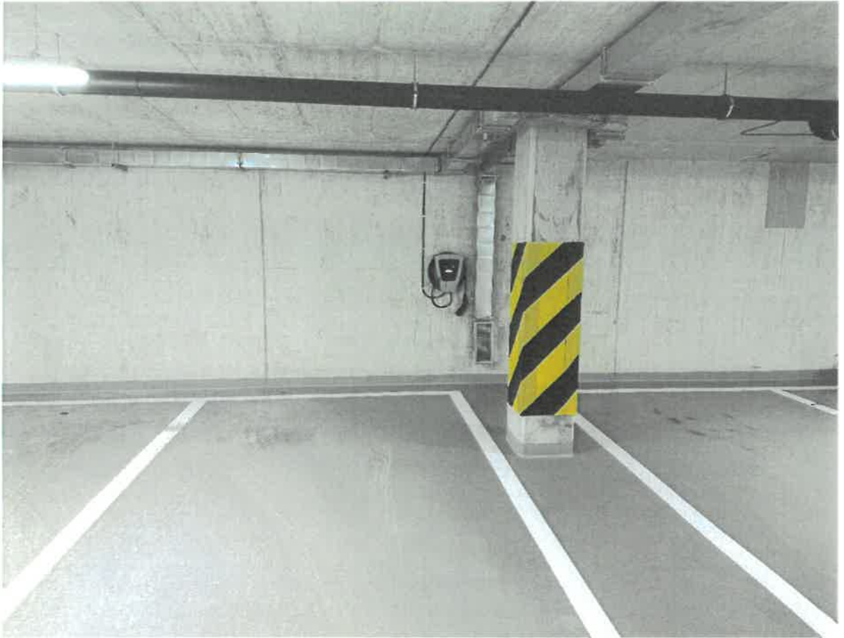
Miejsca postojowe w parkingu podziemnym wraz z ładowarkami elektrycznymi.
