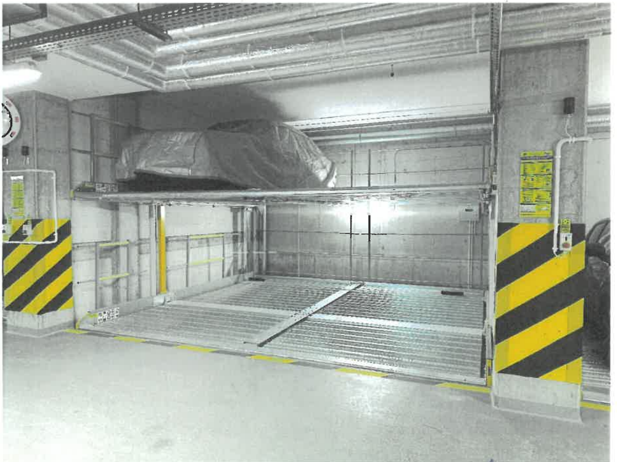
Parking podziemny – platformy samochodowe podwójne.
