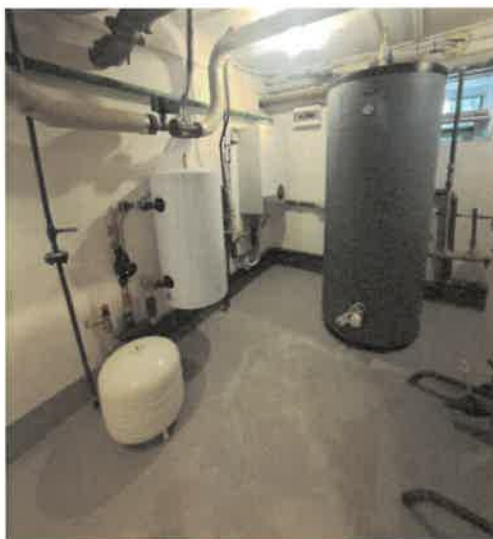
Fot. Pompa ciepła zamontowana w węźle cieplnym budynku i agregat pompy przy ul. Sterniczej 131
