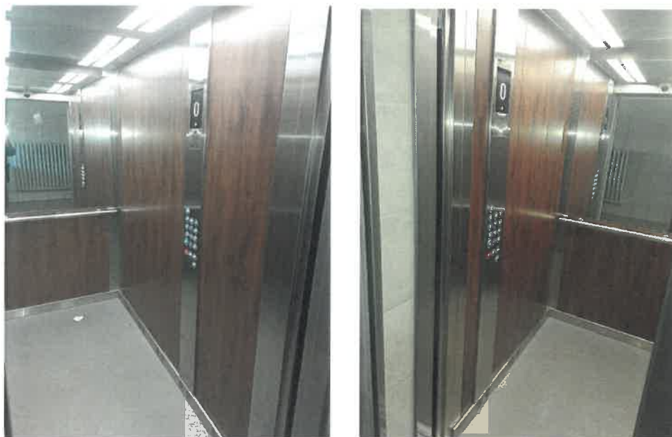
Fot. Wnętrza nowych dźwigów
