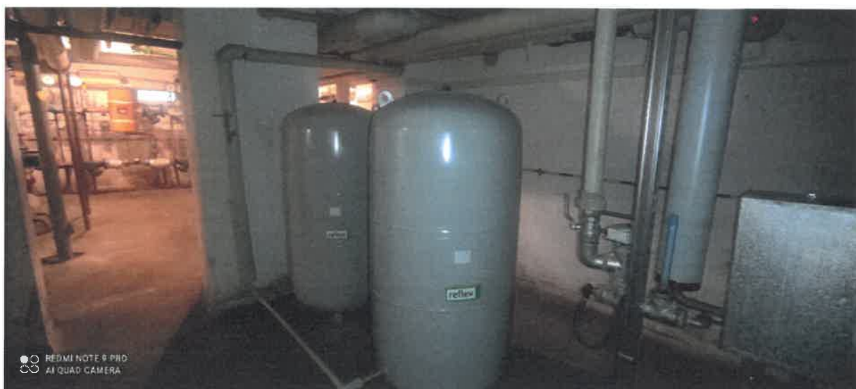
Fot. Zbiorniki wyrównawcze węzeł c.o. ul. Rozłogi 2
