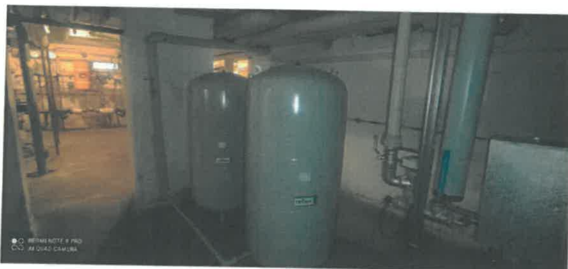
Fot. Zbiorniki wyrównawcze węzeł c.o. ul. Rozłogi 2
