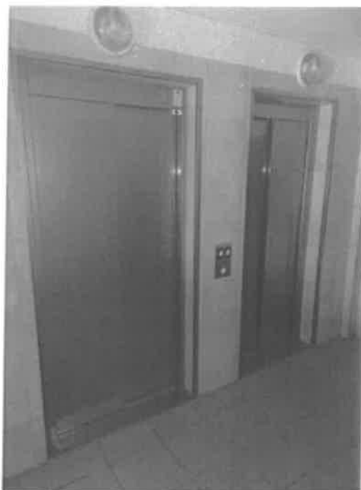
Fot. Dźwig meblowy i osobowy na parterze budynku Lazurowa 2A
