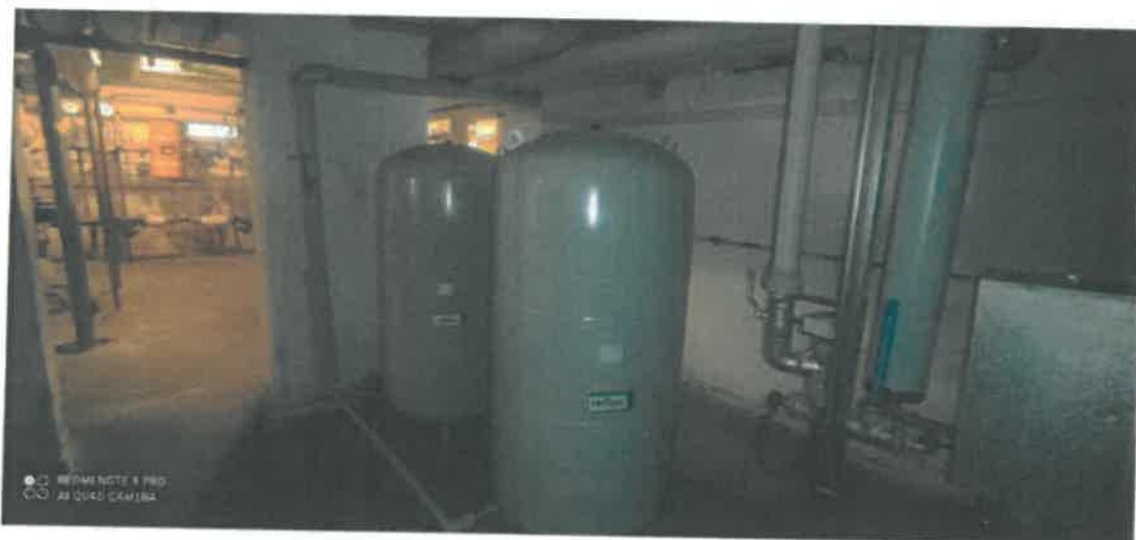
Fot. Zbiorniki wyrównawcze węzeł c.o. ul. Rozłogi 2
