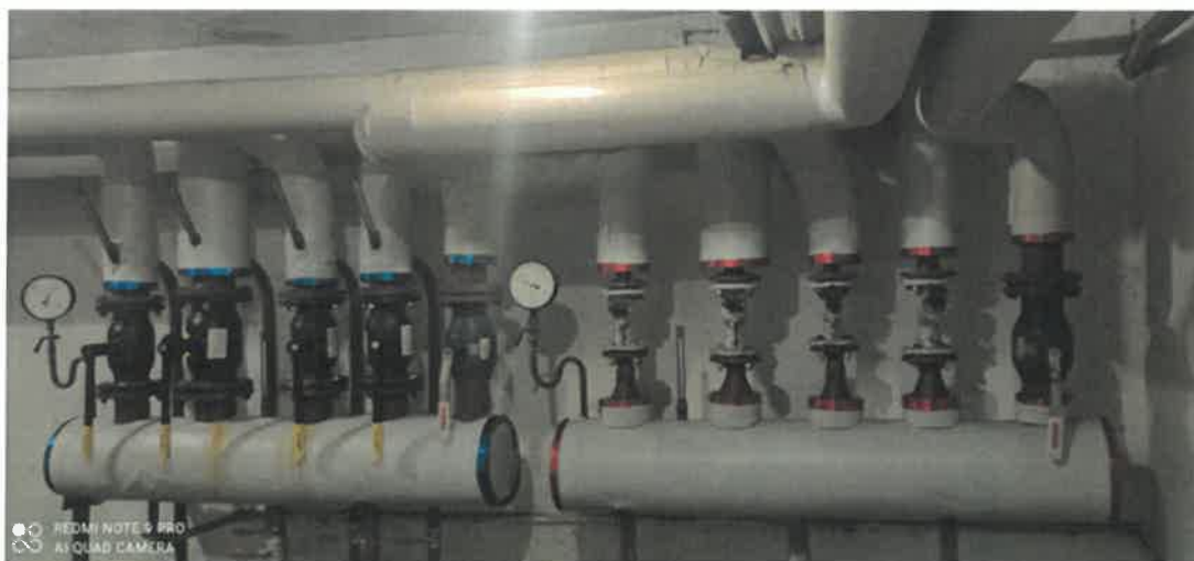
Zdjęcie- Nowe zawory na instalacji centralnego ogrzewania w budynku Rozłogi 2
