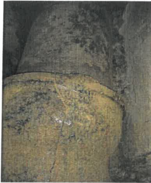
Zdjęcie nr 1- pęknięty kielich rury żeliwnej poziomu kanalizacyjnego w budynku Rozłogi 7
