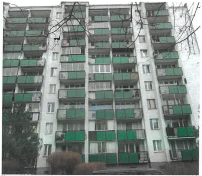
fot. balustrady balkonowe w budynku Rozłogi 6
