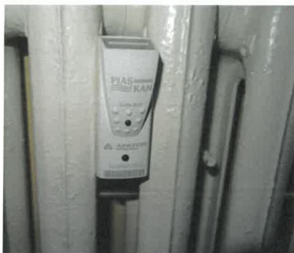
fot. zamontowany podzielnik kosztów ogrzewania w jednym z lokali naszego osiedla.
