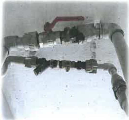
Skorodowany zawór kulowy
