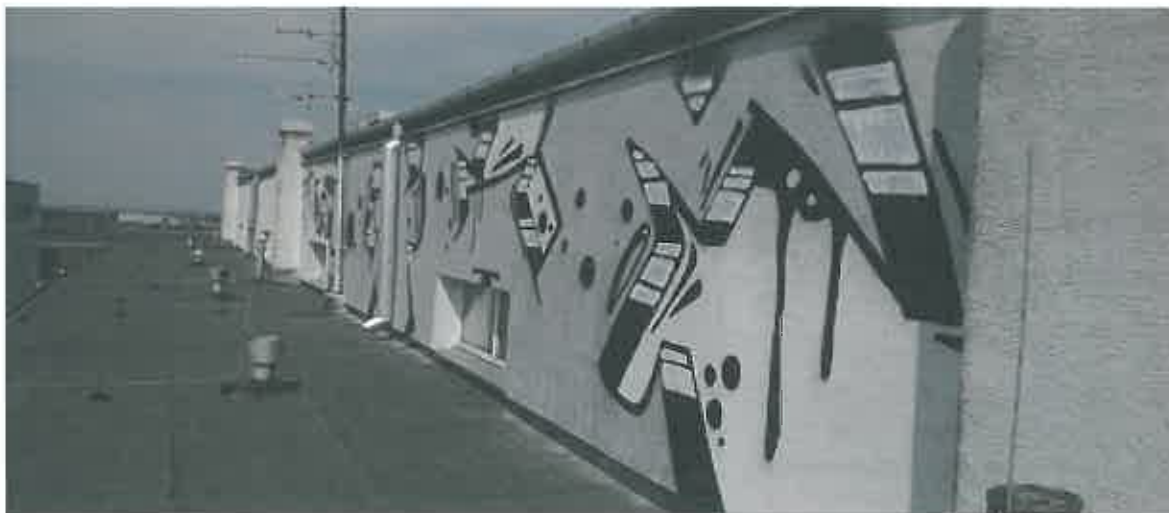
Fot. Zdewastowana elewacja zwyżki na budynku Rozłogi 9
