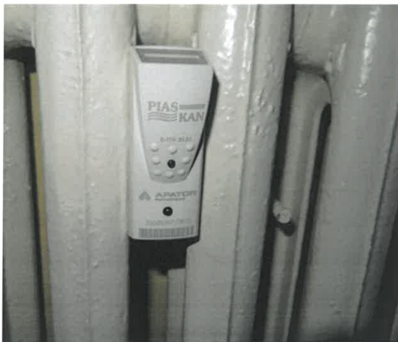
fot. zamontowany podzielnik kosztów ogrzewania w jednym z lokali budynku Rozłogi 3.
