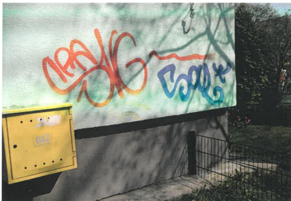
fot. Zdewastowana elewacja południowa budynku Rozłogi 6.
