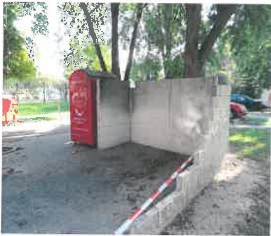
Pozostałość po spalonej altanie śmietnikowej
