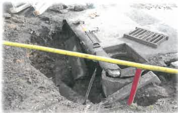
Skutki uszkodzenia konstrukcji studni przy budynku Siemiatycka 1
