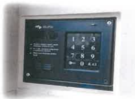
Nowa tablica KDC w budynku Lazurowa 12 kl. II
