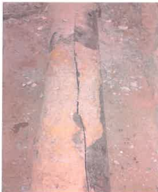
Fot. podłużne pęknięcie odkopanej rury kanalizacyjnej w klatce III budynku Sternicza 131.
