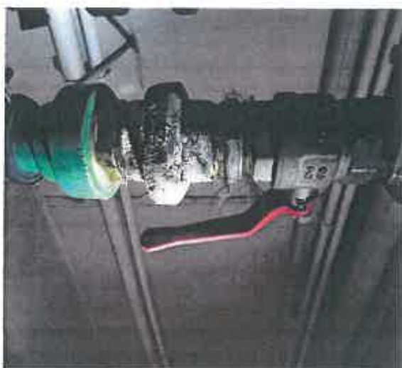
Skorodowany zawór kulowy
