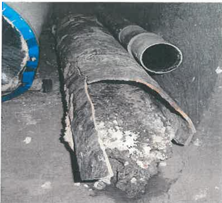
fol. Uszkodzenia rury kanalizacyjnej i osady wypełniające ok. połowy średnicy.
