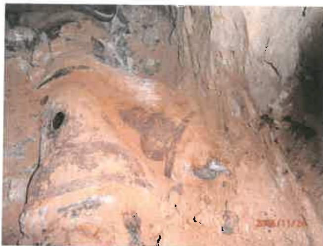
Fot. Odkrywka i fragment poziomej rury kanalizacyjnej z uszkodzonym trójnikiem w budynku Lazurowa 12
