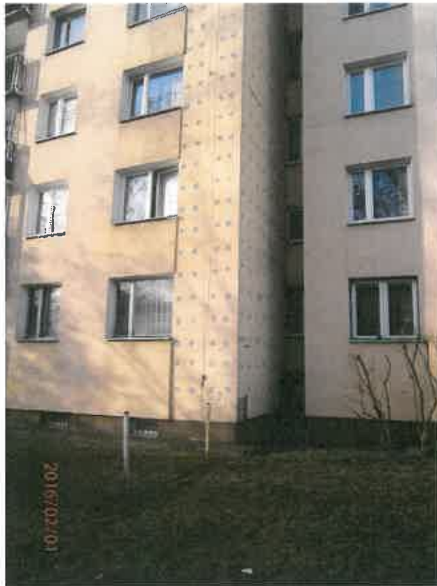
Fot. Zabezpieczona wnęka na budynku Lazurowa 6 przy kl. II
