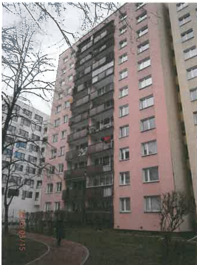
Fot. Pion balkonów w budynku Lazurowa 4 przed remontem.
