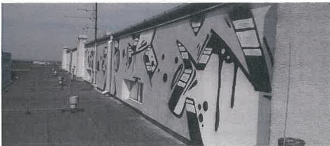
Fot. Zdewastowana elewacja zwyżki na budynku Rozłogi 9
