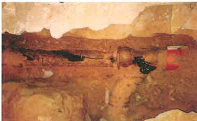
Fot. Fragment starej uszkodzonej rury kanalizacji poziomej w piwnicy budynku Siemiatycka 1 klatka I.
